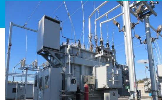
Trạm biến áp
