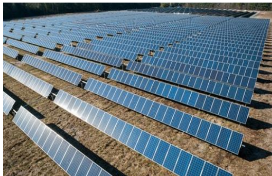
Nhà máy điện
